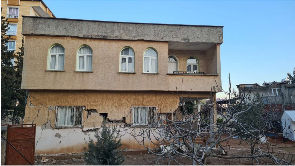
Şekil 3.31. Duvar hasarı bulunan bina (İslâhiye)
