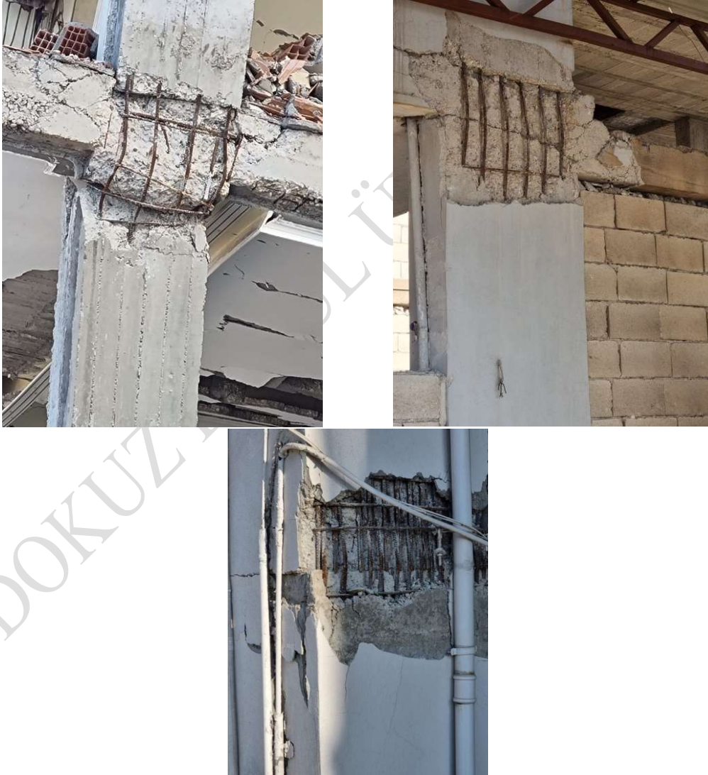
Şekil 3.21. Ağır hasar görmüş binaların kolon-kiriş birleşim bölgesinde yapılan imalat hataları (Nurdağı ve İslâhiye)
