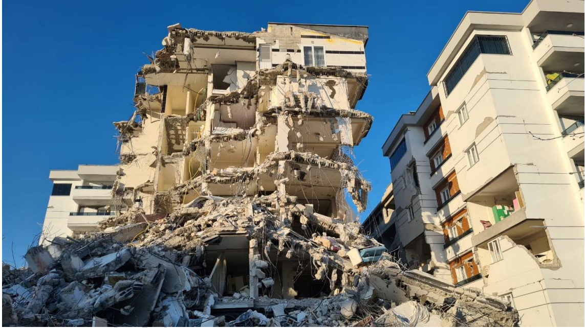
Şekil 3.23. Kısmi olarak göçmüş bina (Nurdağı)
