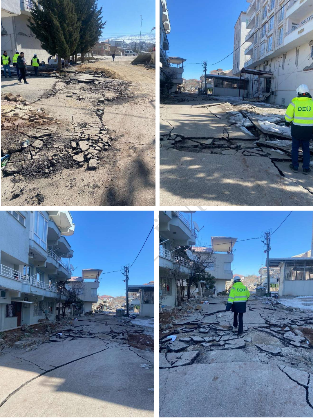
Şekil 3.7. Gölbaşı- Adıyaman zemin sıvılaşmasının yarattığı yol kaplamasında meydana bozulma
