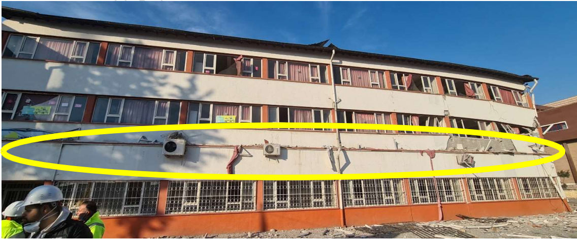
Şekil 3.27. Ara katı göçmüş okul binası (Kahramanmaraş)
