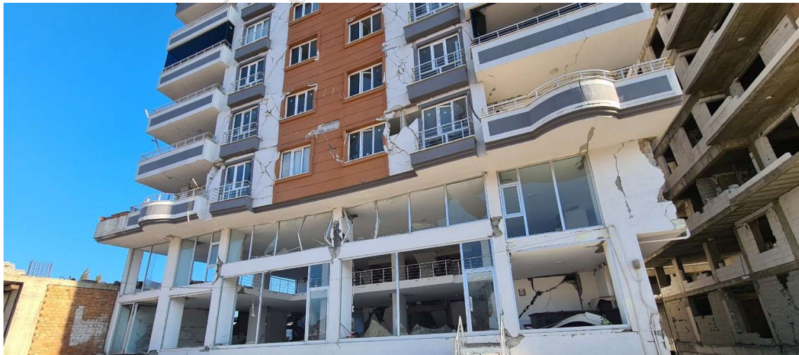
Şekil 3.29. Duvar hasarı bulunan bina (Nurdağı)
