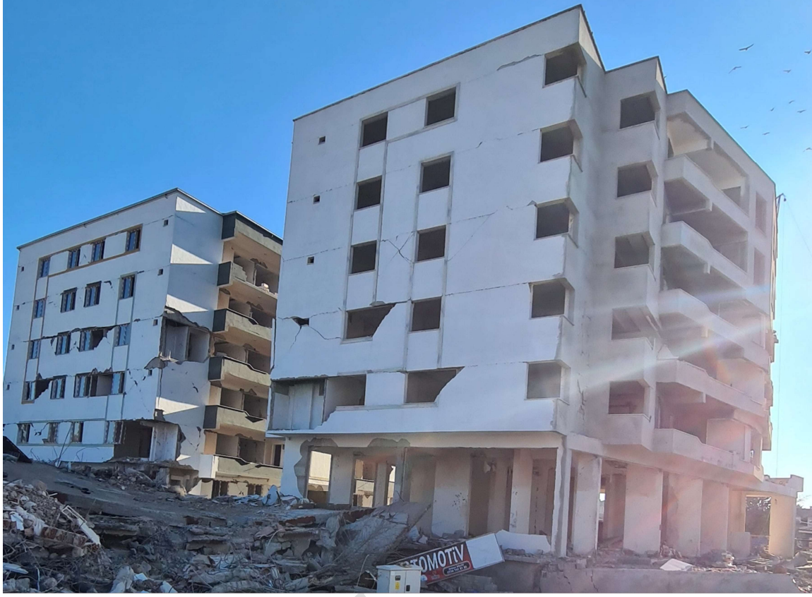
Şekil 3.30. Duvar hasarı bulunan bina (Nurdağı)
