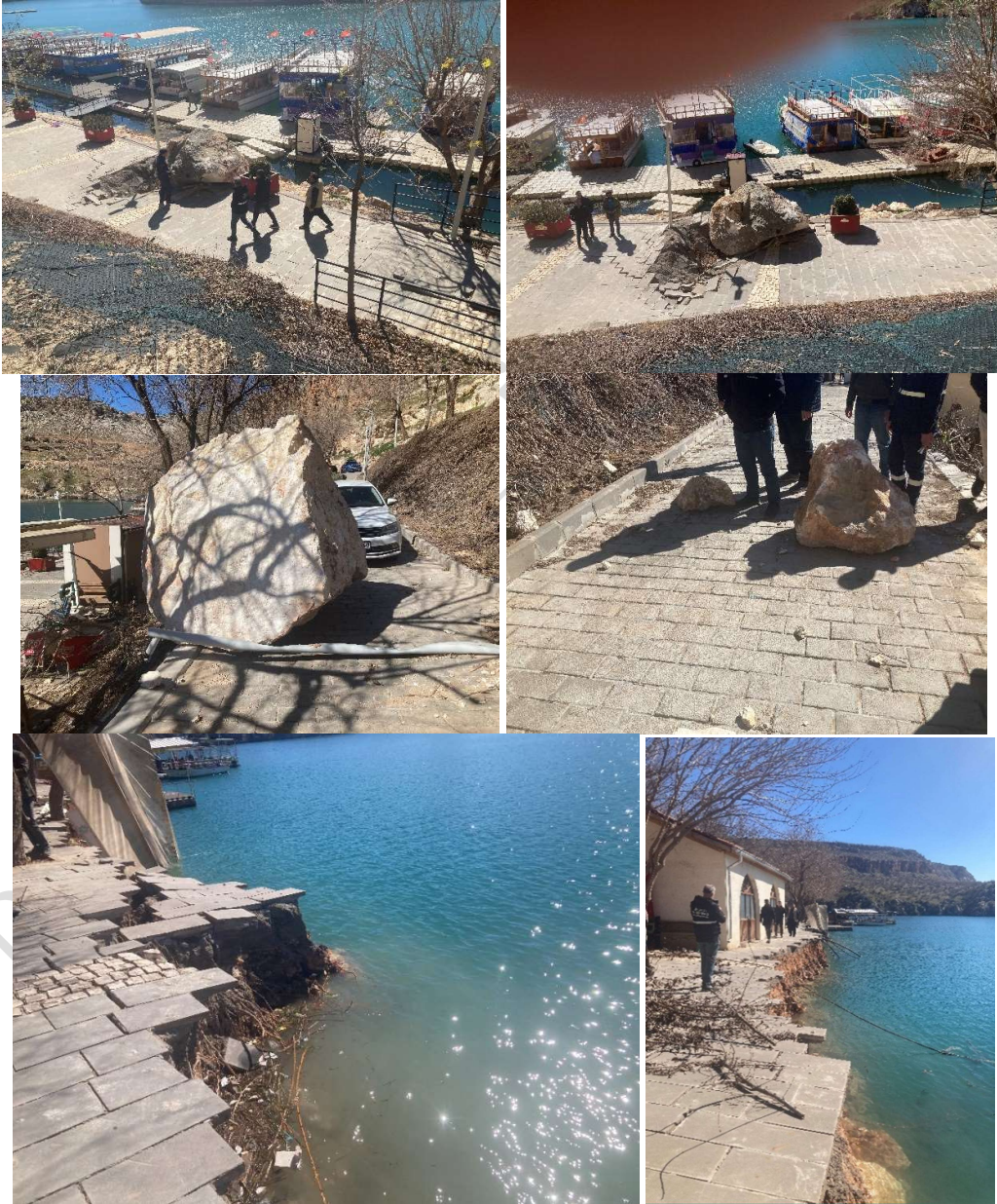
Şekil 3.4. Kaya düşmesi sonucu oluşan hasar türleri (Birecik Baraj Gölü)
