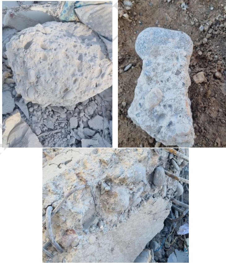
Şekil 3.15. Yıkılmış binalardan kopan beton parçaları
