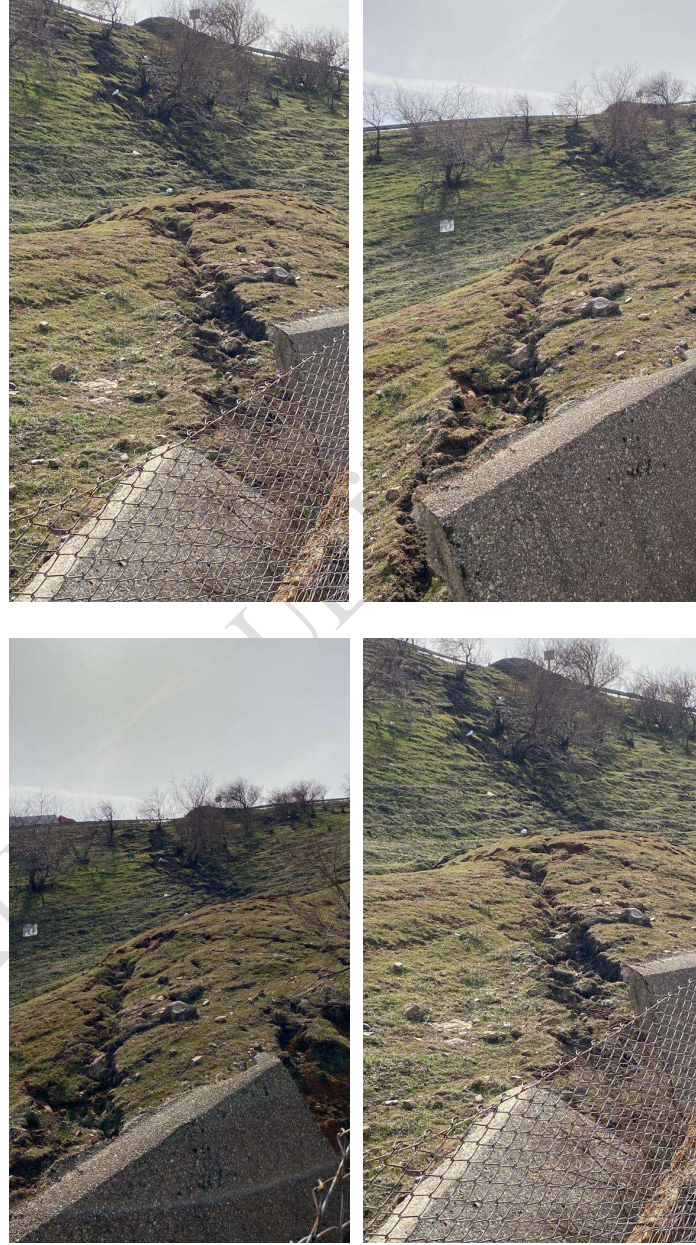
Şekil 3.10. Gaziantep – Adıyaman Otoyolu dolgu şevi hasarı
