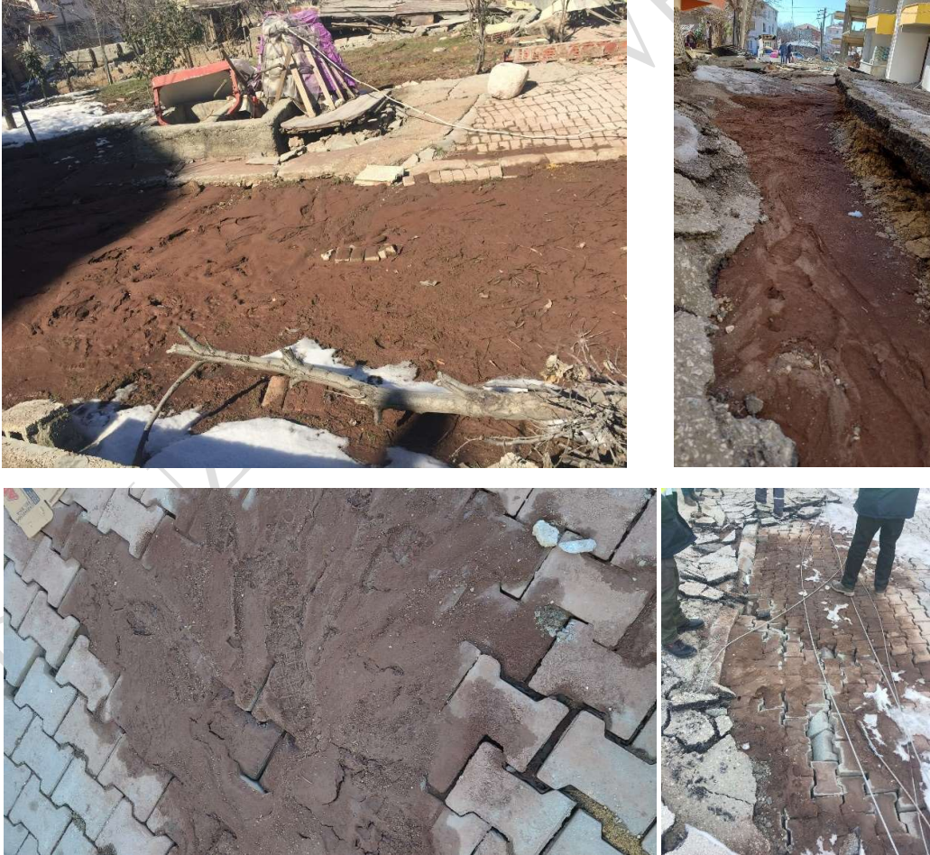
Şekil 3.1. Adıyaman Gölbaşı'nda yüzeyde tespit edilen sıvılaştıran zemin izleri
