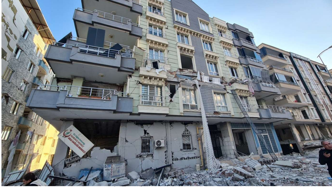
Şekil 3.28. Duvar hasarı bulunan bina (Nurdağı)
