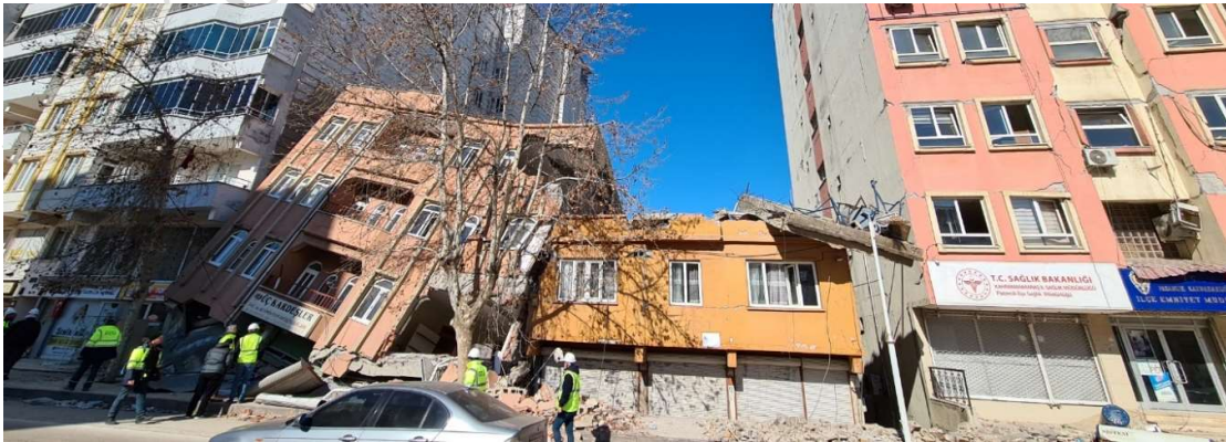
Şekil 3.24. Alt katında dükkân olan kısmi göçmüş bina (Pazarcık)
