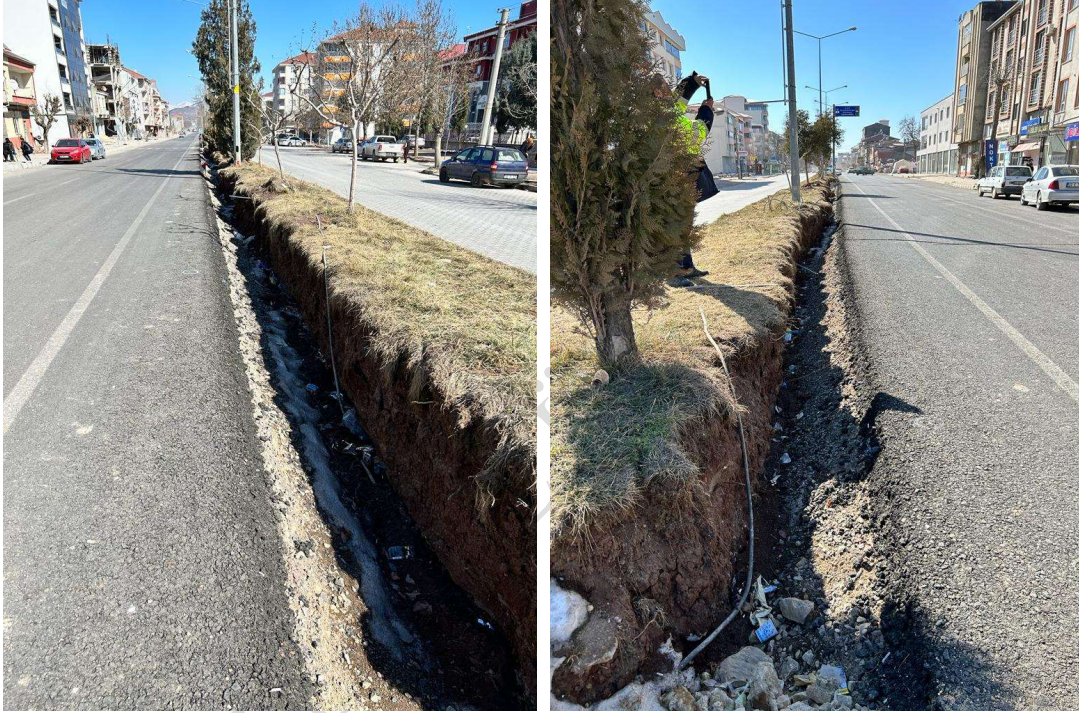
Şekil 3.6. Gölbaşı- Adıyaman zemin sıvılaşması sonrası zemine batan yol kaplaması
