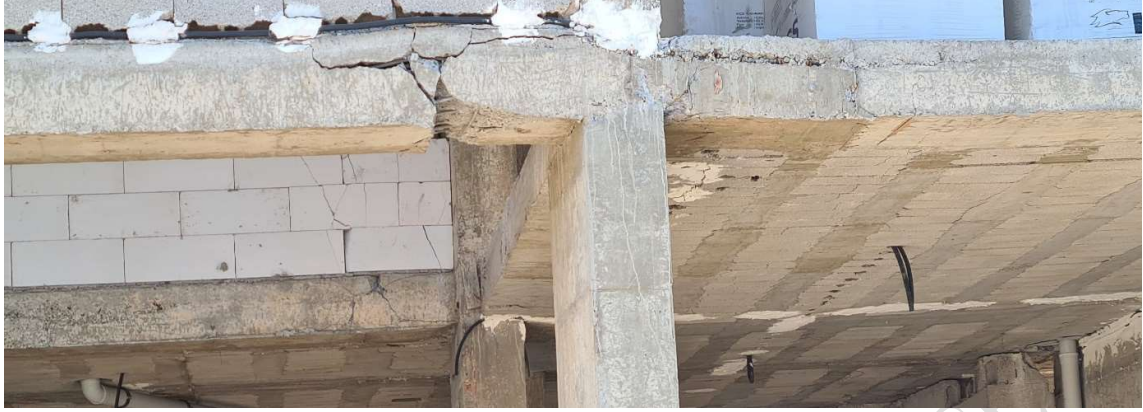
Şekil 3.22. Kirişi kırılan ağır hasarlı bina (Nurdağı)
