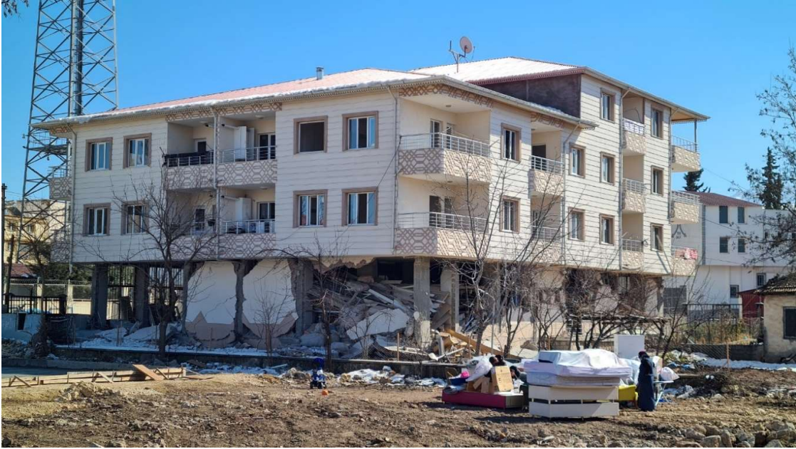
Şekil 3.33. Duvar hasarı bulunan bina (Gölbaşı)
