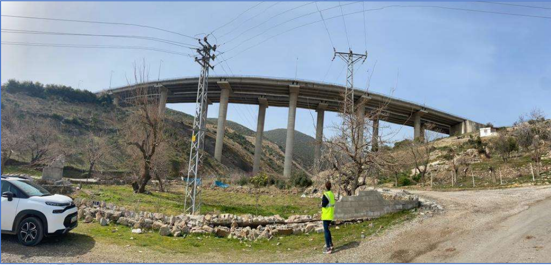
Şekil 3.14. Turgut Özal Viyadüğü deprem sonrası mevcut durumu
