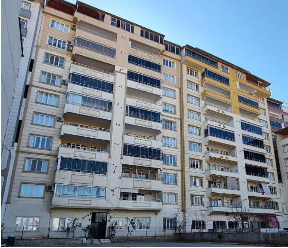
Şekil 3.32. Duvar hasarı bulunan bina (Pazarcık)
