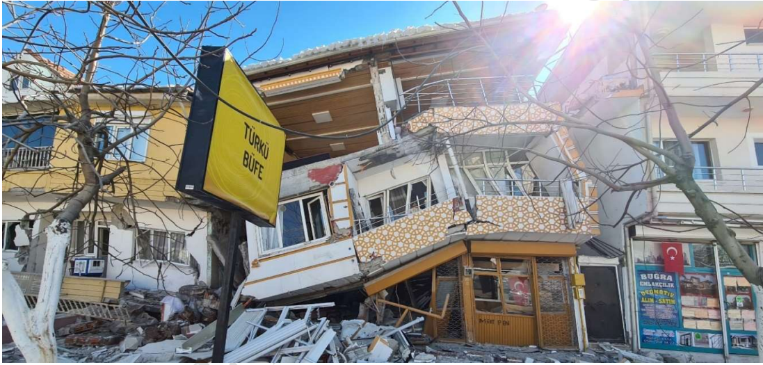
Şekil 3.26. Alt katında dükkan olan kısmi göçmüş bina (Gölbaşı)
