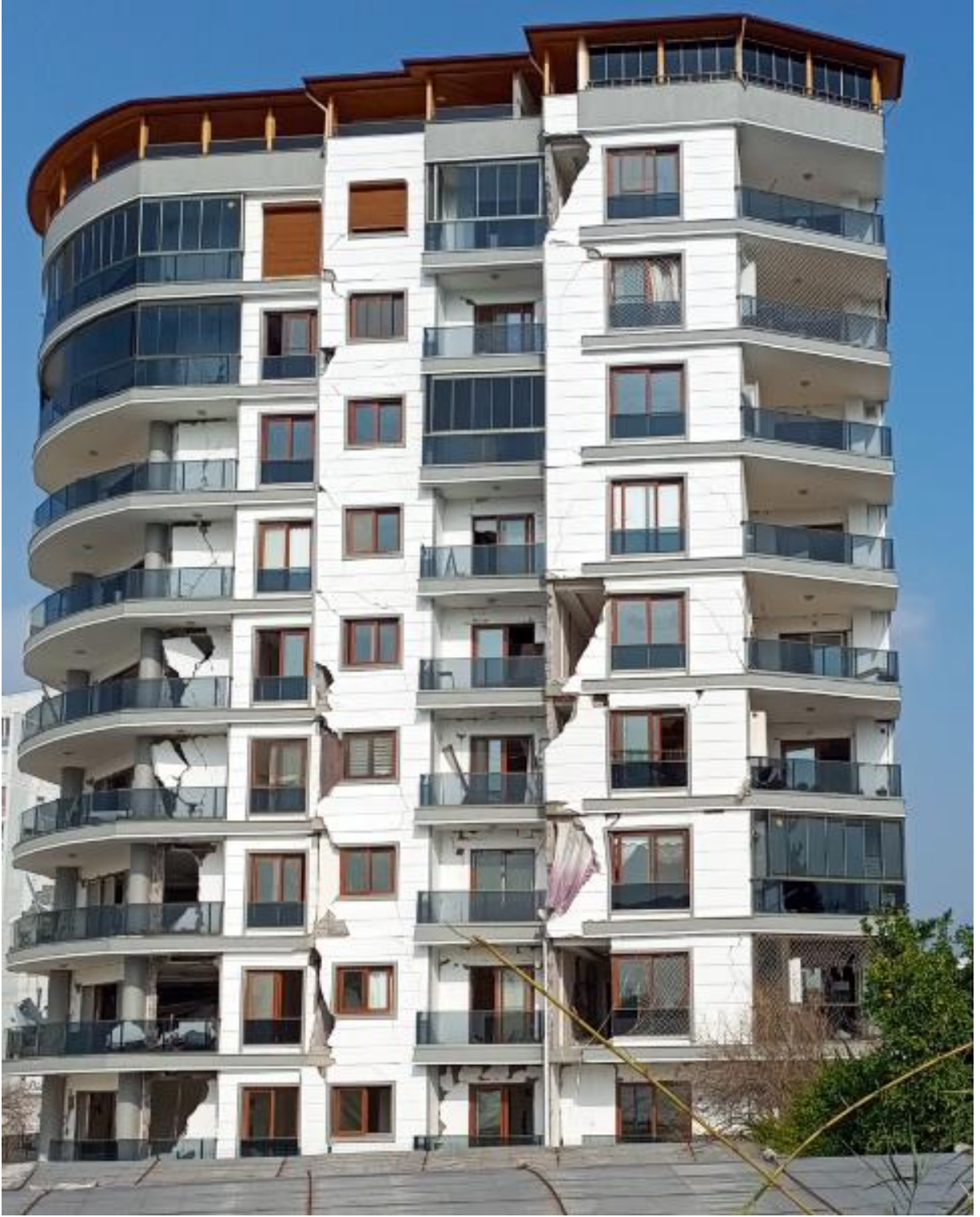
İskenderun'da yüksek katlı yapıda gözlenen deformasyonlar
