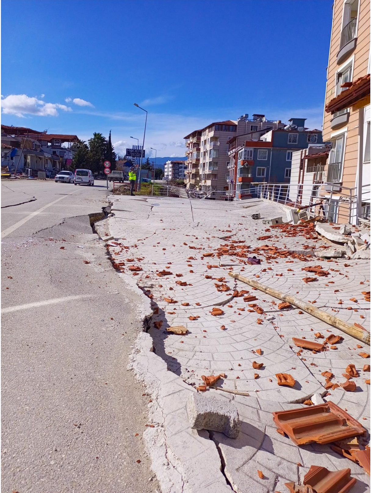
Antakya'da gözlenen yüzey deformasyonları
